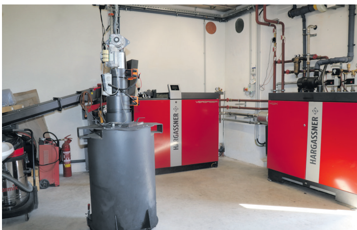
Diese Kraft-Wärme-Kopplungsanlage steht auf einem Mostviertler Betrieb und erzeugt aus Hackschnitzeln Wärme & Strom. Links im Bild ist der Verdampfer, rechts der Stromerzeuger zu sehen.
