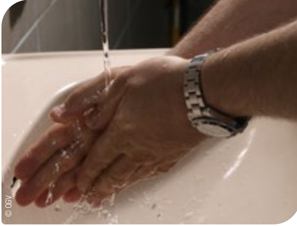
Abb. 43: Der Vorraum muss über geeignete Händewascheinrichtungen verfügen.
