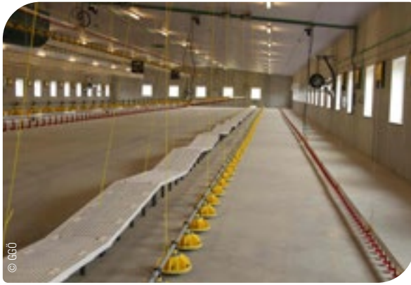
Abb. 97: Futter- und Wasserlinien werden im Stall abwechselnd montiert, wobei an der Wand mit einer Wasserlinie begonnen wird.
